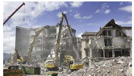
Juli 2012: Die Abbrucharbeiten sind in vollem Gange. Bis auf die Villa Gerber werden alle Gebäude abgerissen. Markus Hubacher
