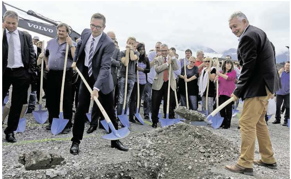
Thuns Stadtpräsident Raphael Lanz (SVP) und Transfair-Direktor Rolf Glauser (rechts) beginnen mit dem Bau des neuen Betriebsgebäudes, während sich die anderen geladenen Gäste im Hintergrund bereithalten.
